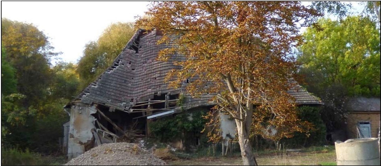
Außenansicht der Südostseite des abzureißenden Wohnhauses mit eingestürztem Bereich
